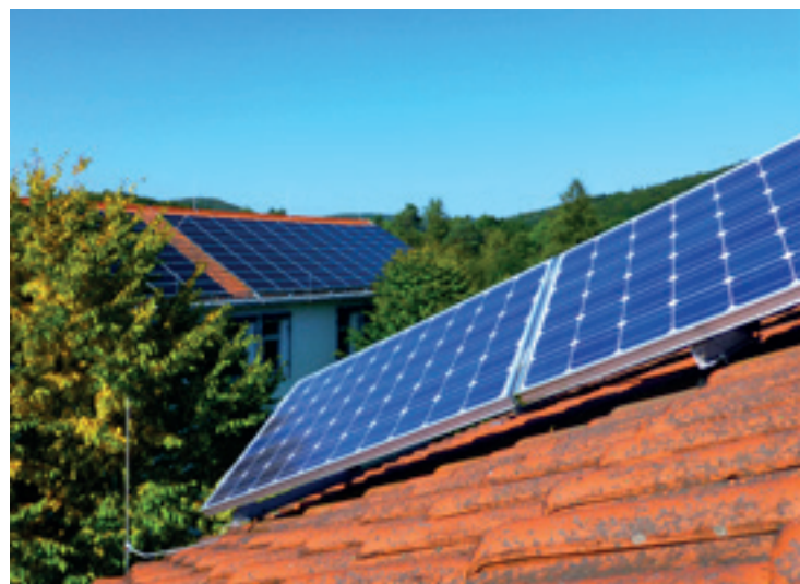
PV-Module auf den Dächern eines Campus-Gebäudes
