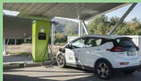
Ladesäule für E-Autos
