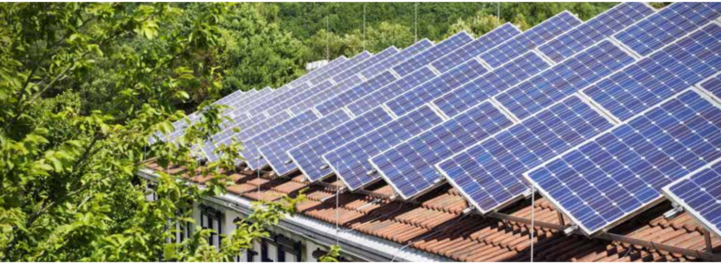
Photovoltaikanlagen auf dem Dach der Hochschule
