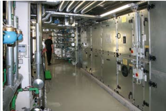
Bild 10: Zentrales RLT-Gerät des Auditorium maximum
