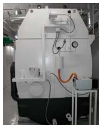
Bild 13: Adsorptionskältemaschine mit angeschlossener Vakuumpumpe
