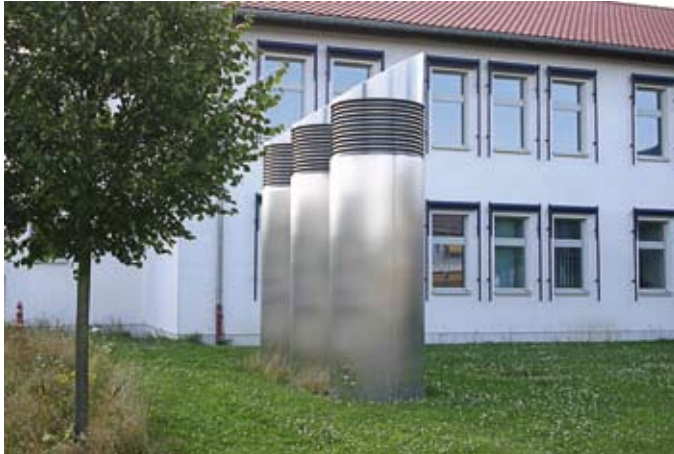
Bild 6: Außenlufttürme des Zentralen Neubaus
