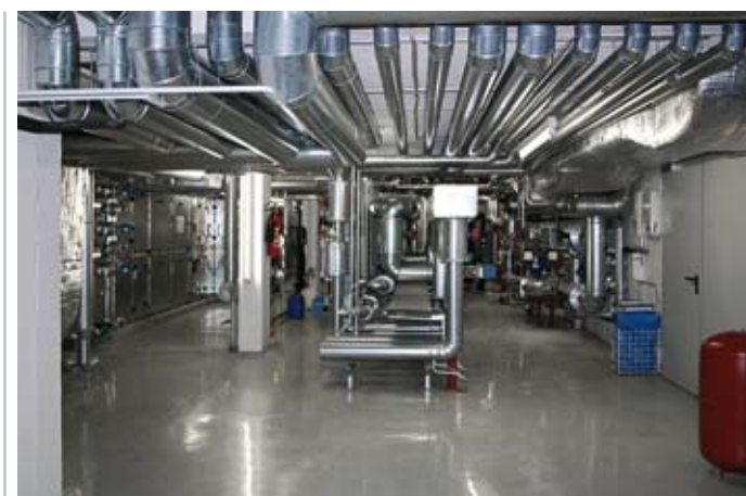
Bild 4: Technikzentrale des Zentralen Neubaus
